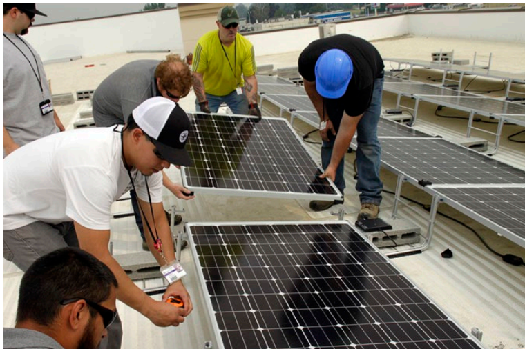
Perry Technical Institute, 15.68 kW por paneles solares
