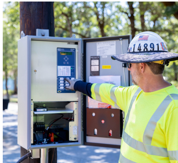
Control avanzado de los reconectores
